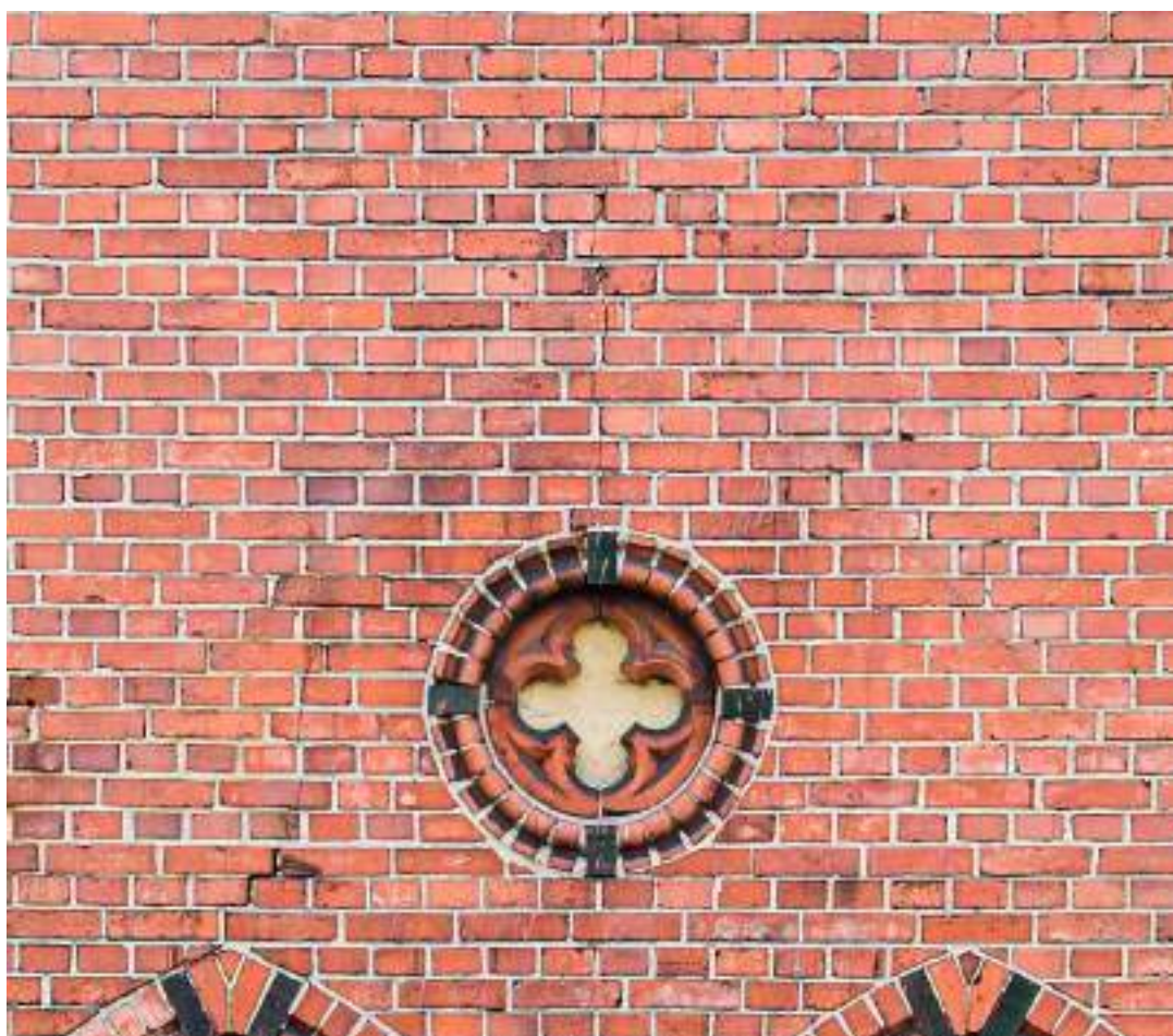
Zdjęcie nr 3. Uszkodzenia będące wynikiem wstrząsów górniczych.
